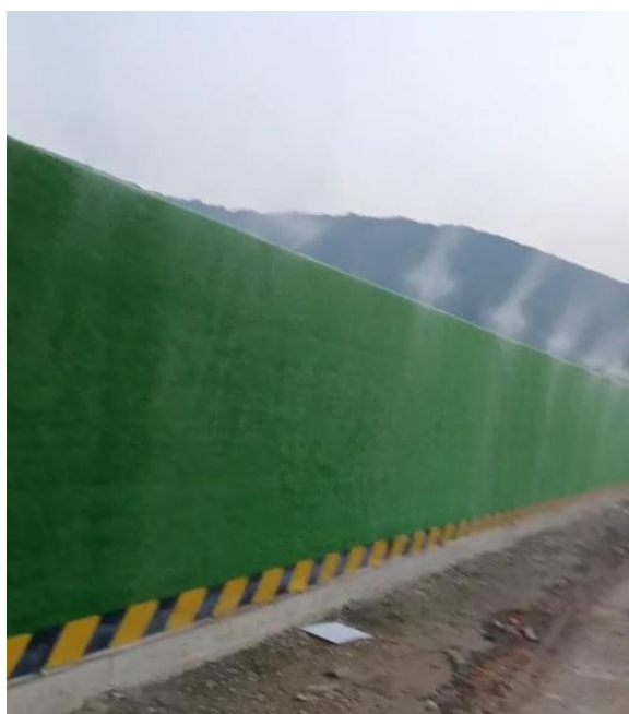
围挡及喷淋抑尘系统
