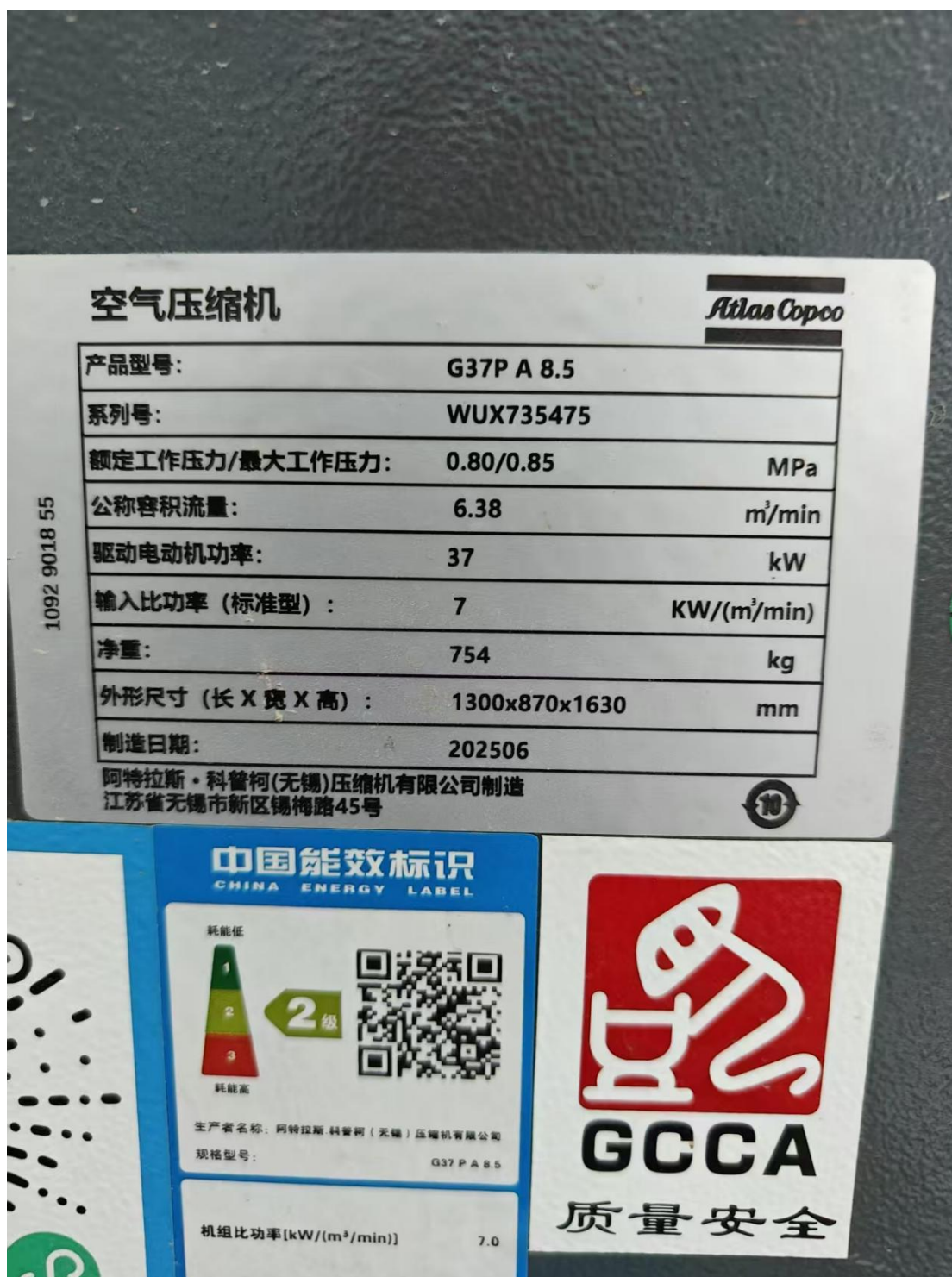
图 5-3 脱水机房空压机
