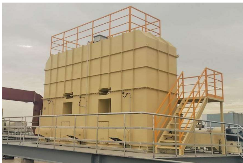
图 7.1-2 CO 蓄热催化燃烧实物图
