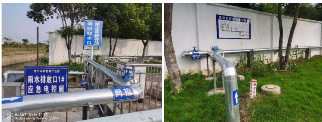
图 7.6-7 园区雨水回流管网现场照片
