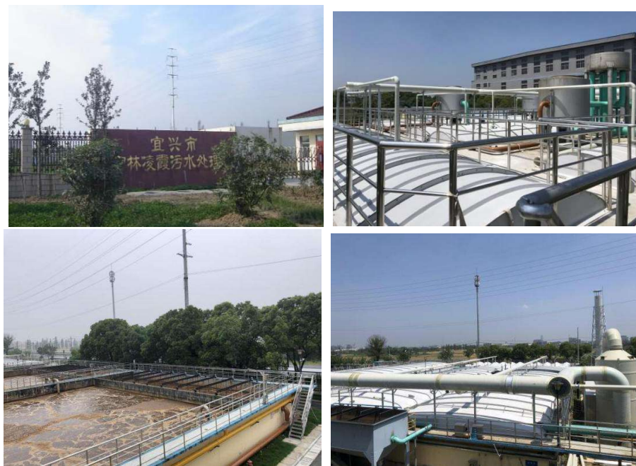
图 7.2-2 凌霞污水处理厂现场照片
