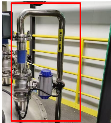
图 4-3 密闭设备管道收集
