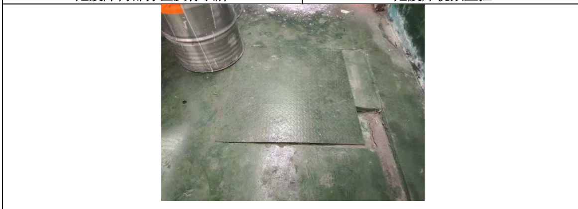
危废库内部导流沟及收集池
